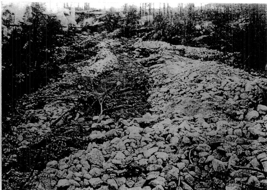
Foto 5: Caminho destruído com pedra fragmentada
